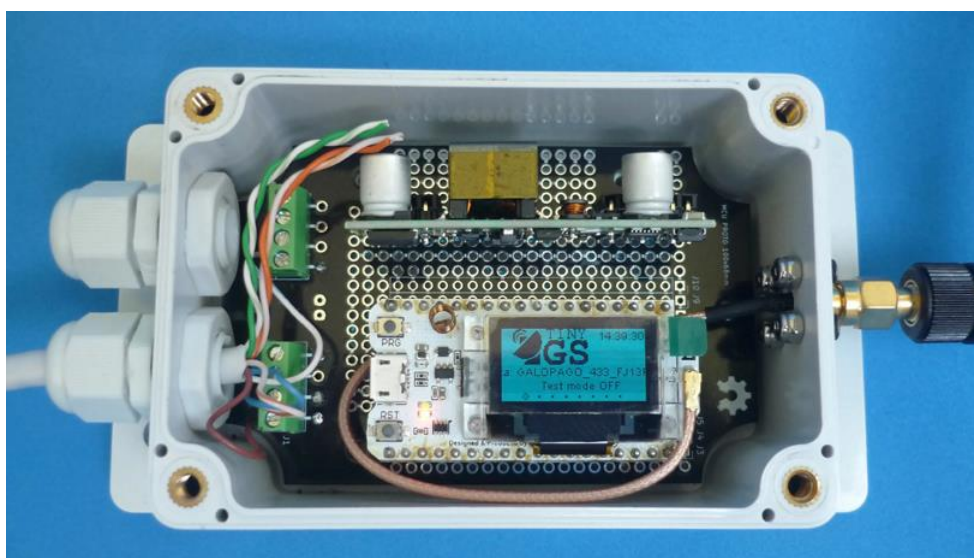
Fot. 3.8. Przykład umieszczenia odbiornika w hermetycznej obudowie
