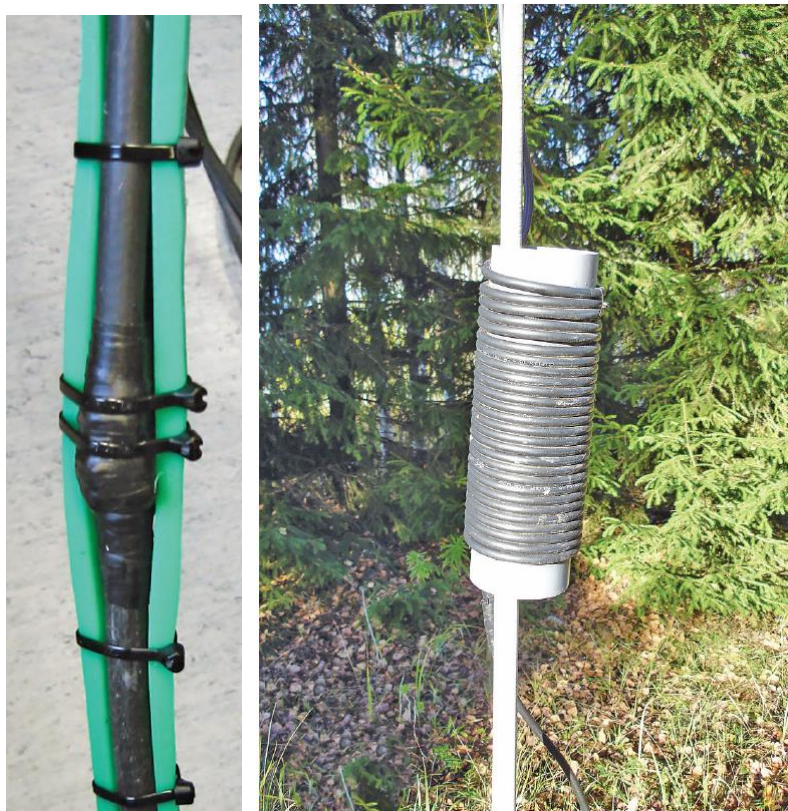
Fot. 1.2.9.4. Jako wzmocnienie połączeń służą plastikowe łubki, do których wiązadłami są przywiązane końce kabli
