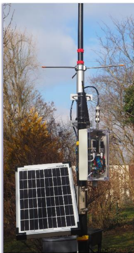
Rys. 3.1.5. Dwupasmowy i dwusystemowy węzeł MeshComu i Meshtasticu zainstalowany na zewnątrz i zasilany z baterii słonecznej
